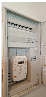
Sikringskap med automatsikringer og strømmåler.
