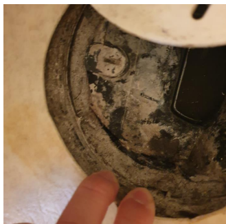
Løst belegg rundt sluk, ingen klemring å se.
