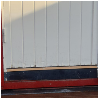
Råte/svulming nederst ved terrassedøra mot sør.
