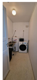
Overblikk av vaskerommet. Malte flater på vegger som i utgangspunktet er uegnet for vannpåkjenning.
