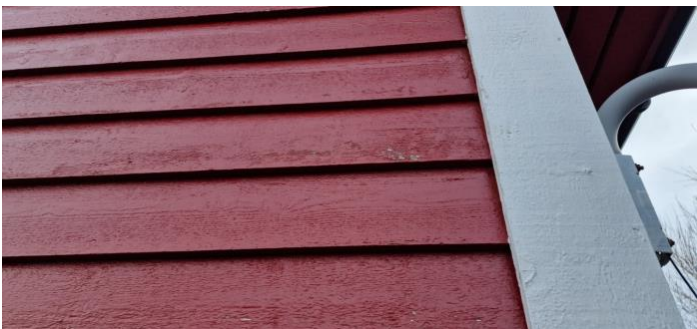
Område med litt maling som flasser, område er over inngangspartiet.
