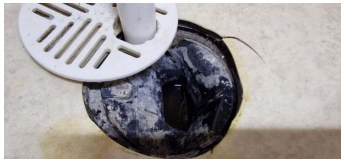
Sprekk i belegg.
