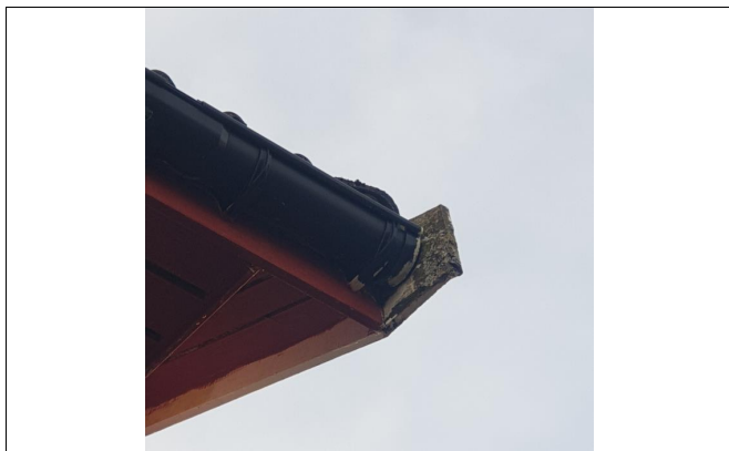
Noe mosevekst på nordlig vindski.
