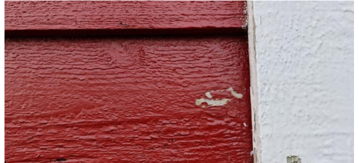
Nært foto av maling som flasser.
