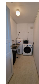
Overblikk av vaskerommet. Malte flater på vegger som i utgangspunktet er uegnet for vannpåkjenning.
