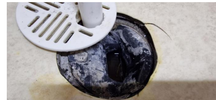
Sprekk i belegg.
