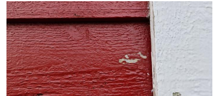
Nært foto av maling som flasser.
