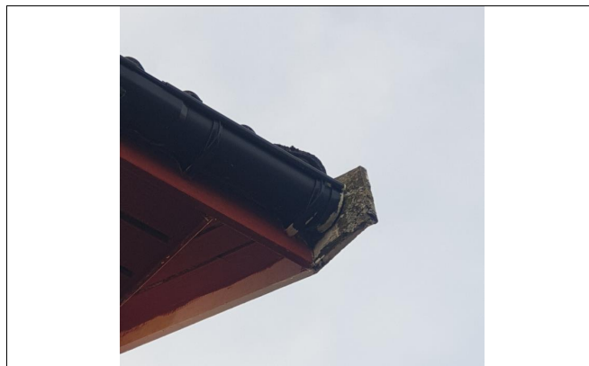
Noe mosevekst på nordlig vindski.
