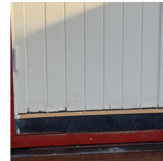
Råte/svulming nederst ved terrassedøra mot sør.
