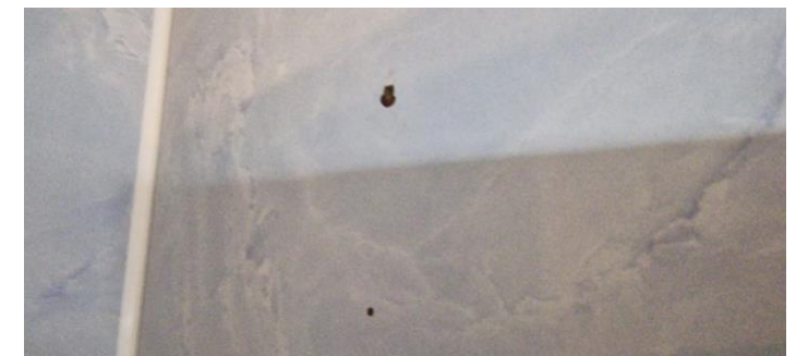
Små silikonerte hull i våtromsplater på bad.
