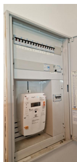
Sikringskap med automatsikringer og strømmåler.
