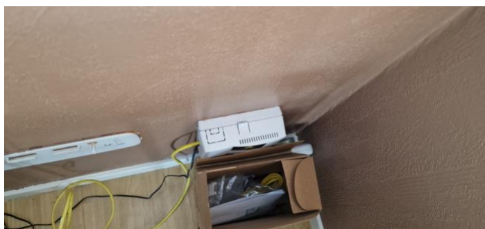
Inntak for fiber plassert i soverommet i 1.etg.
