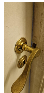
Løse skurer ved håndtak, tiltak må forventes.
