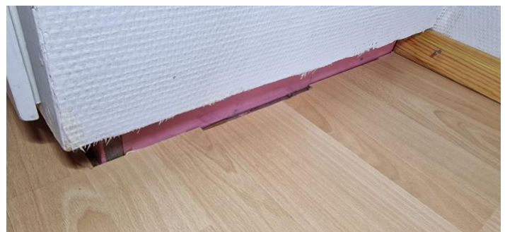
Enkelte områder mangler avsluttende listverk.
