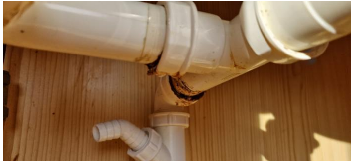
Det er en pågående lekkasje ved koblinger under vask.
