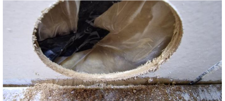
Malt "Korea"-panel, dette er en tynn plate. ellers ingen plater bakom, men det er montert dampsperre, det er i utgangspunktet ikke anbefalt, da dampsperran holder på fuktig tilsig fra terreng som kommer inn bakom dampsperran og kan holde organisk materiale ,som treverk fuktig.
