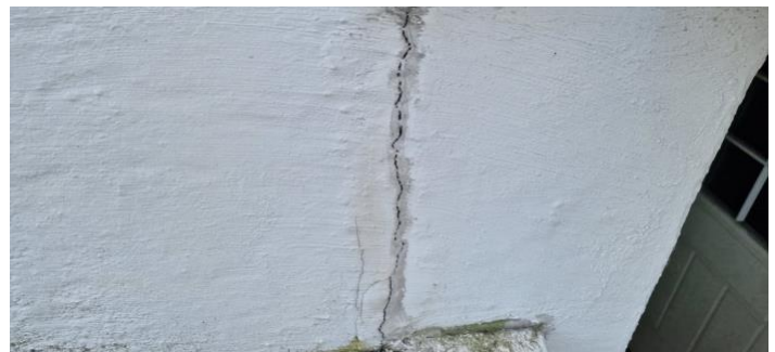
Sprekk ved betongtrapp og tilbygg ved inngangspartiet.
