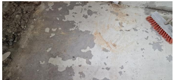
Flassing på malte betongflater.
