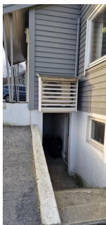
Fallfare ved betongtrapp og forstøtningsmur.
