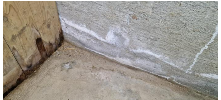
Saltutslag er observert ved bod i kjeller.
