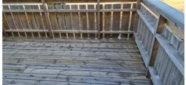
Ubehandlet terrassebord og rekkverk ved balkong/altan i 2.etg.
