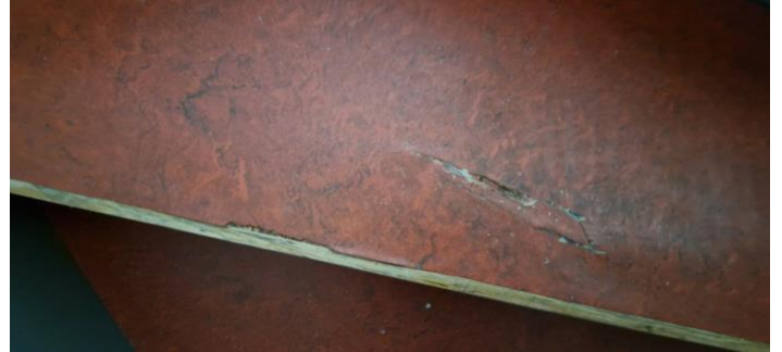
Skadet belegg ved inntrinn i trapp ved 2.etg.
