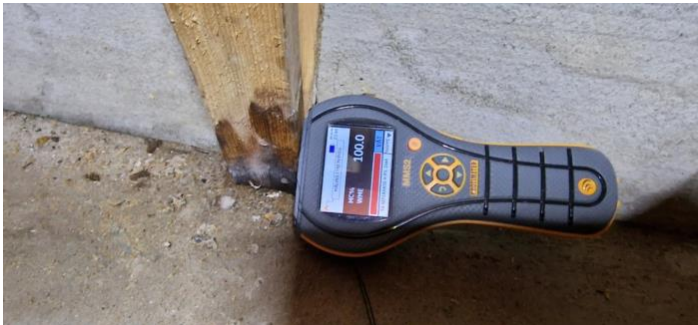
Nedre deler av treverk trekker til seg fukt tilsig fra grunn, metta treverk. Råtedannelse er startet.
