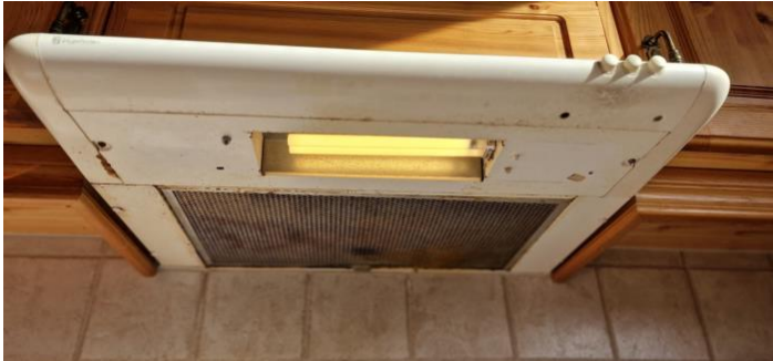
Avtrekk over koketopp.
