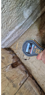
Fukt utslag på fuktindikator ved betongdekke mot grunn.
