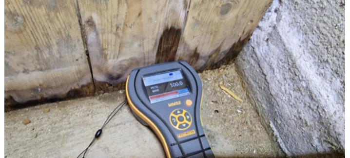
Nedre deler av treverk trekker til seg fukt tilsig fra grunn, metta treverk. Råtedannelse er startet.
