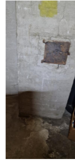
Bod 2: Sotluke i kjelleren, observert små sprekker over luken. Generelt noe rust å sotluken.
