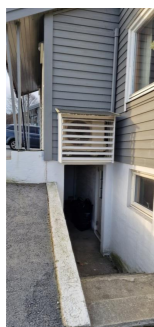
Fallfare ved betongtrapp og forstøtningsmur.
