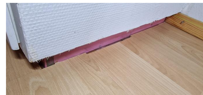
Enkelte områder mangler avsluttende listverk.
