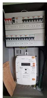
Sikringsskapet har ny strømmåler og automatsikringer.
