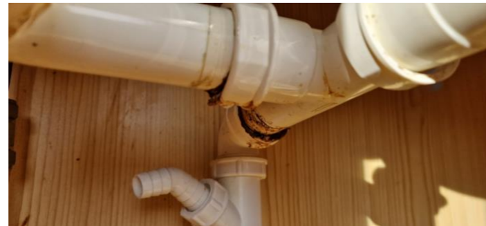
Det er en pågående lekkasje ved koblinger under vask.
