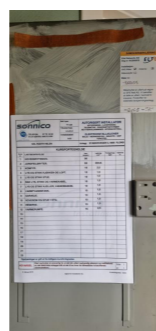
Kursfortegnelse samsvarer med antall sikringer merket i sikringsskapet.
