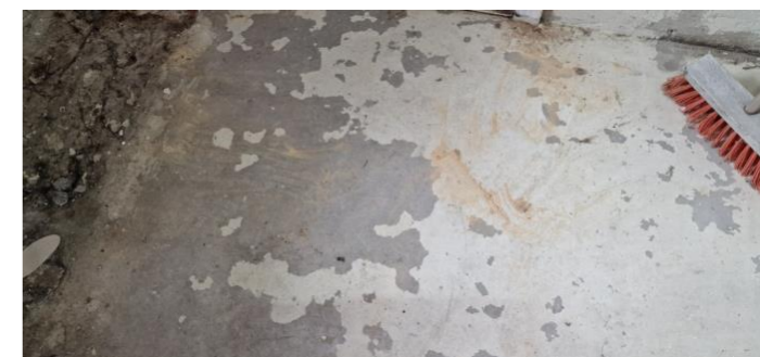
Flassing på malte betongflater.
