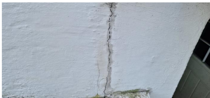
Sprekk ved betongtrapp og tilbygg ved inngangspartiet.
