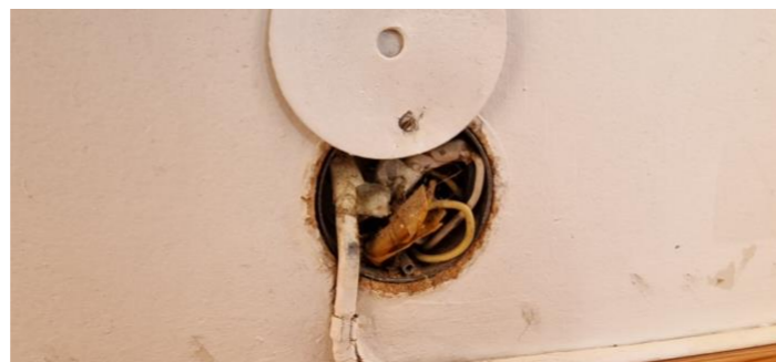
Deksel er plassert ved bakkenivå, hvor barn kan ferdes. Dekselet kan enkelt skyves vekk og eksponerer ledninger. Påregn tiltak for å lukke avviket.
