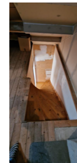
Mangler håndløper og rekkverk, fallfare.
