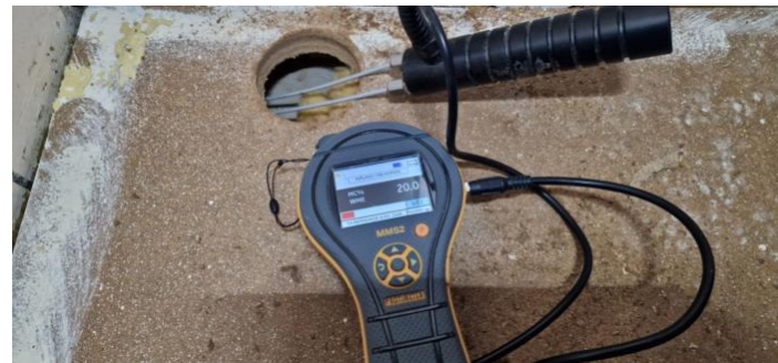
20% - ikke ok, gulv kan får råteskade ved å stå i fuktig klima over tid.
