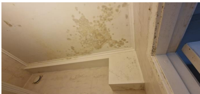
Svertesopp merker i himlingen, vegger og dørlister til badet. Kun naturlig ventilasjon.
