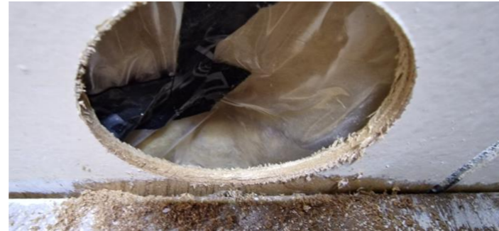
Malt "Korea"-panel, dette er en tynn plate. ellers ingen plater bakom, men det er montert dampsperre, det er i utgangspunktet ikke anbefalt, da dampspærren holder på fuktig tilsig fra terreng som kommer inn bakom dampspærren og kan holde organisk materiale ,som treverk fuktig.
