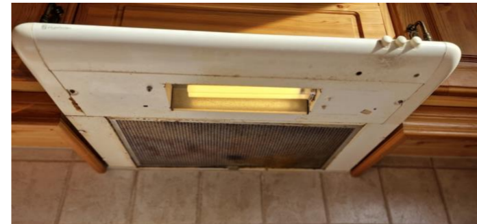
Avtrekk over koketopp.
