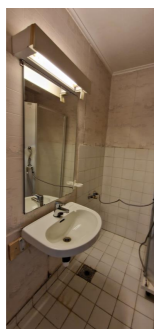
Vegghengt vask lekker under ved kobling ved funksjonstest.
