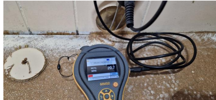
20.7% - ikke ok. treverk o.l. kan får råteskade ved å stå i fuktig klima over tid.
