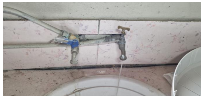
Noe korrosjon ved kobling til blandedbatteri over vask. Synlige kobberrør.
