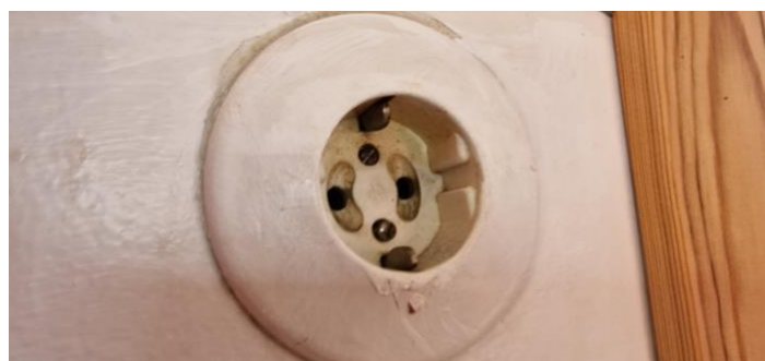
Stikk henger løst og det er en løs skure inni. Påregn tiltak.
