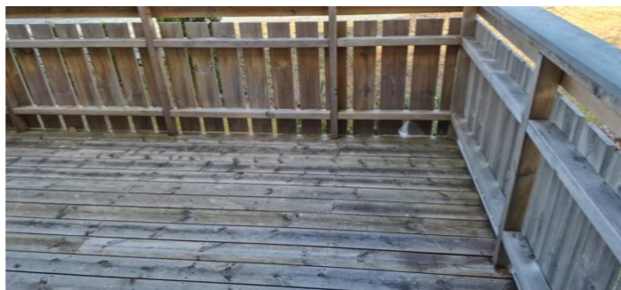
Ubehandlet terrassebord og rekkverk ved balkong/altan i 2.etg.
