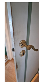
Slitasje på dørblad, maling mangler.
