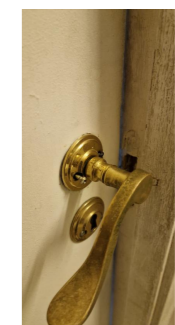
Løse skurer ved håndtak, tiltak må forventes.
