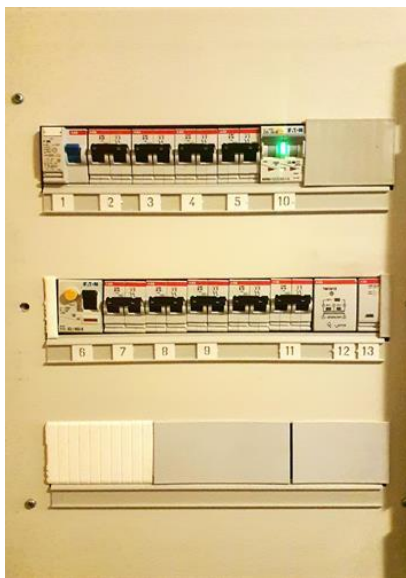
Elektrisk anlegg - [Sikringskap]
