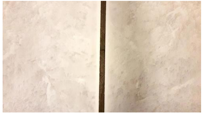
Våtrom - [Riss i fuger på bad ]
