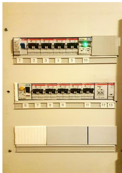
Elektrisk anlegg - [Sikringskap]
