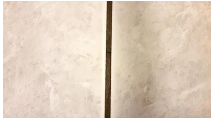
Våtrom - [Riss i fuger på bad]
