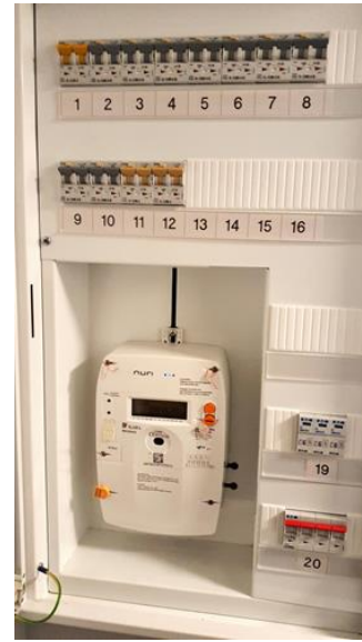
Elektrisk anlegg - [Sikringskap]
