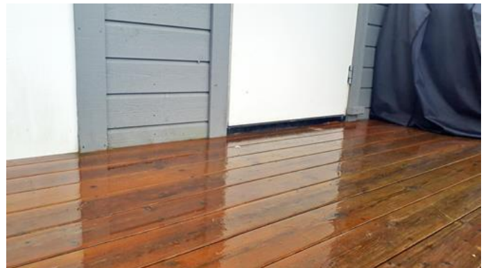
Yttervegger inkl. fasader og konstruksjon - [Liten avstand mellom terrasse og kledning]
