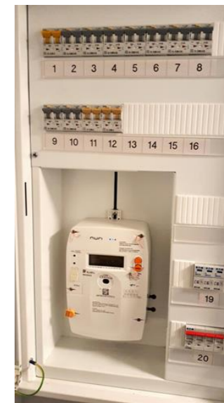
Elektrisk anlegg - [Sikringskap]
