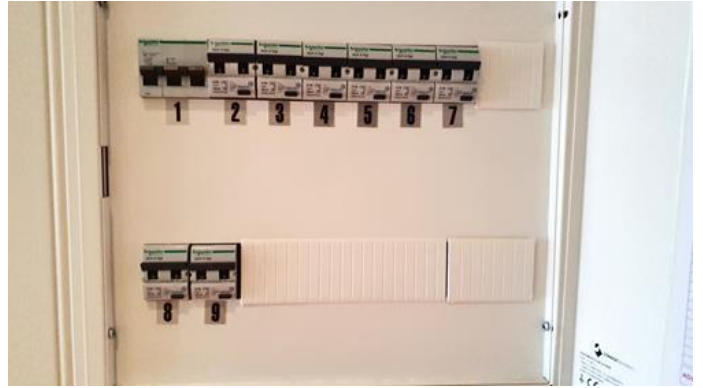
Elektrisk anlegg - [Sikringskap]
