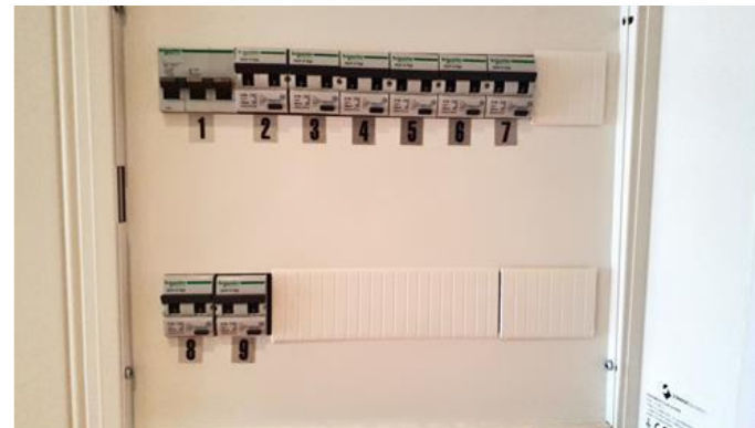
Elektrisk anlegg - [Sikringskap]
