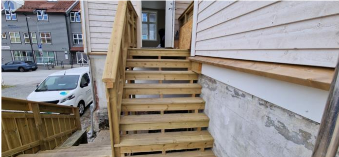
Plassbygd tretrapp. Det er observert skjevheter ved tretrappen. Sett fra midtre støtte nede ved terrassen og ved topp midtre støtte er det ca. 2.5 cm forskjell.
