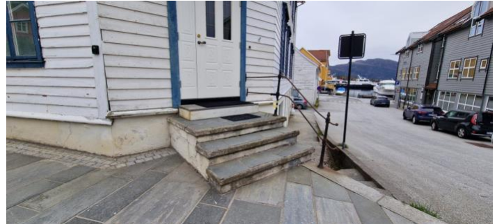
Betong trapp, små spekker enkelte steder. Mangler rekkverk på 1 side. Løst og eldre jern-rekkverk. Påregnet tiltak.
