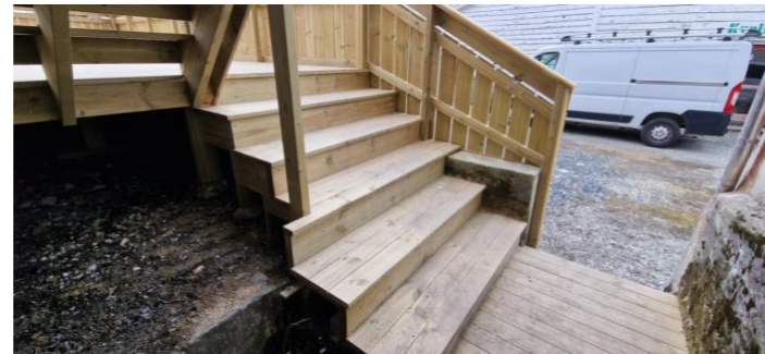
Deler av tretrapp har ikke rekkverk pr.dd.
