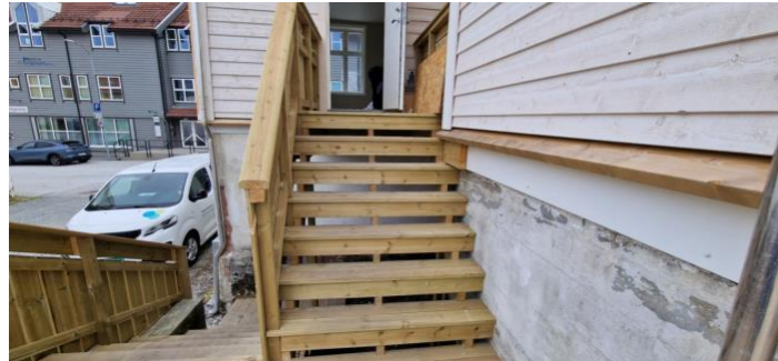
Plassbygd tretrapp. Det er observert skjevheter ved tretrappen. Sett fra midtre støtte nede ved terrassen og ved topp midtre støtte er det ca. 2.5 cm forskjell.
