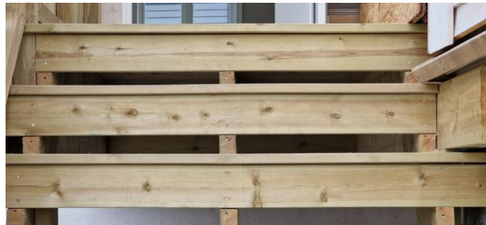
Grønn laser er i flukt nede ved tretrappen og ca. 2.5 cm ut fra tre-støtten under inntrinn.
