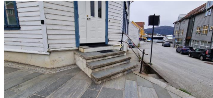
Betong trapp, små spekker enkelte steder. Mangler rekkverk på 1 side. Løst og eldre jern-rekkverk. Påregn tiltak.
