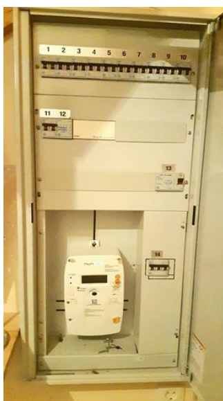
Elektrisk anlegg - [Sikringskap]
