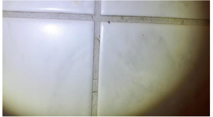
Våtrom - [Riss i fuger]
