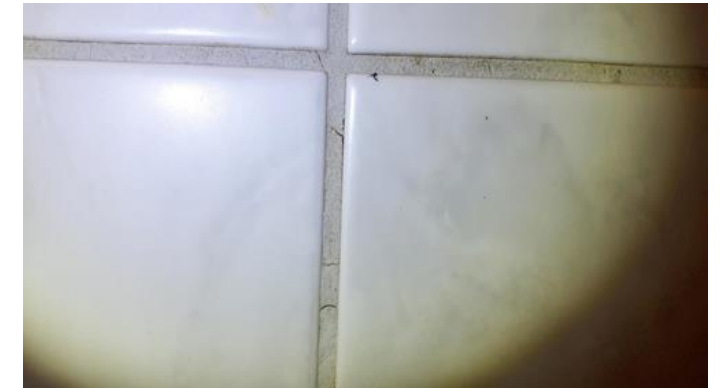
Våtrom - [Riss i fuger]
