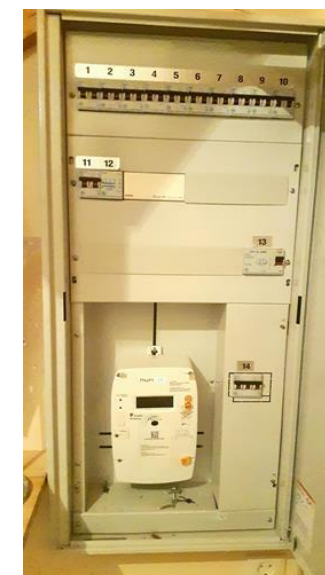
Elektrisk anlegg - [Sikringskapp]
