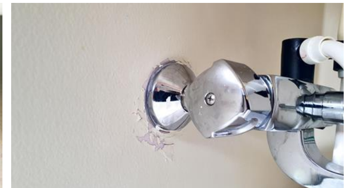
Våtrom - [Løsnet overflatebehandling]
