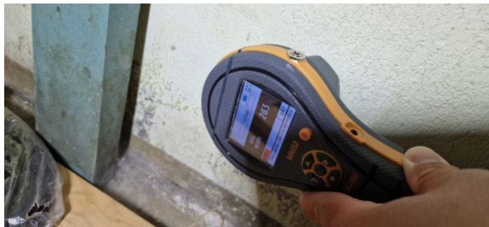
293 av maks 999 ved vegg under terreng.
