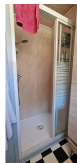
Det er ikke sluk ellers i rommet, og ev. lekkasjevann må over skyvedørskarmen til dusjkabinettet for å lede til sluk.
