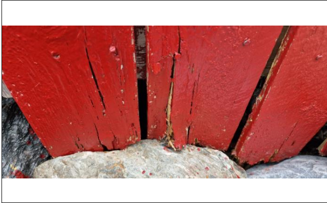
Naust: råte på nedre deler av stående malt kledning.
