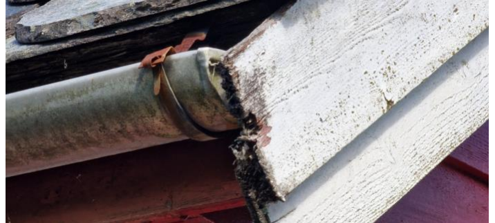
Antatt råtedannelse ved og mulig lekkasje ved endre at takrenne. Påregn tiltak.
