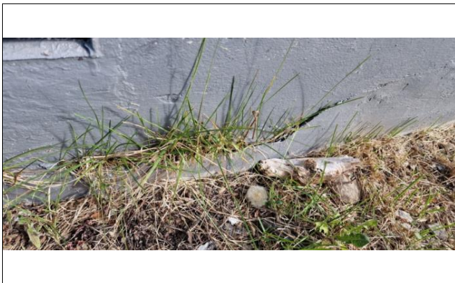
Puss på mur til bolig trenger tiltak.
