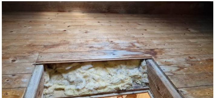
Fuktmerker under eldre jern-vindu ved kaldloftet. Eier opplyser at fuktmerker er opplyst å være fordi tidligere eier glemte å stenge vinduet over en periode. Til informasjon er eldre jern-vindu å anse som en risiko pga. alder.
