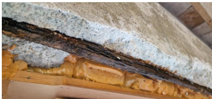
Armeringsjern har rustskader, tiltak bør påregnes.
