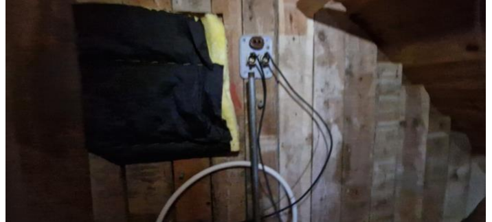
Eldre inntak er frakoblet iht. eier.
