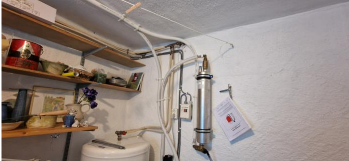
Kobber og rør i rør.
