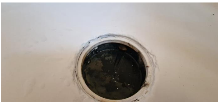
Malt gulv i dusjsonen, eller ikke membran iht. omviser. Plastsluk.
