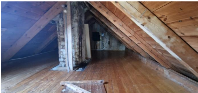
Overblikk av kaldloftet, generelt små sprekker/riss og rennemerker langs pipe.
