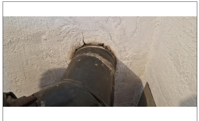
Små riss/sprekker ved inntak av røykløp fra ovn til pipe, sett fra kjeller.
