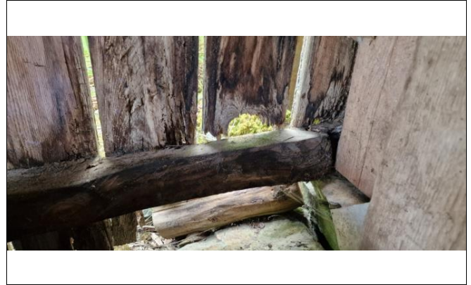
Råte på garasje og kledning.
