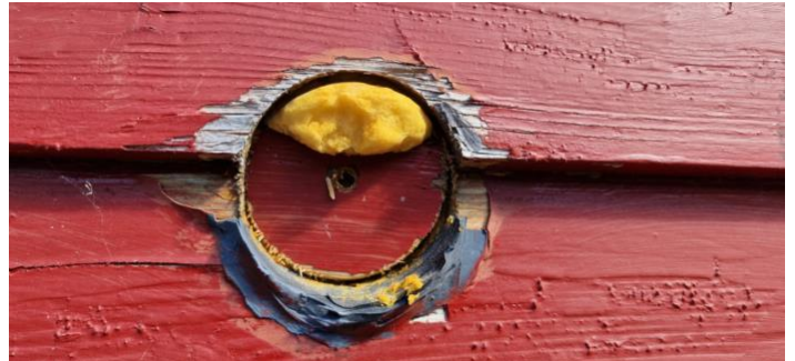
Påregn tiltak på ferdigstilling av tidligere gjennomgang for varmepumpe.
