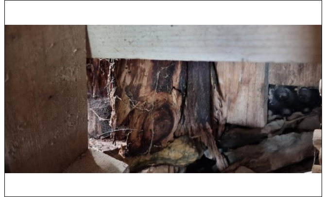
Garasje råte ved søyle. tiltak må forventes.
