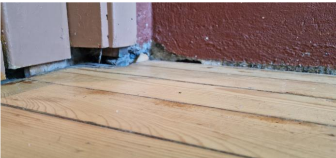
Større glippe mellom gulv og gulv list.
