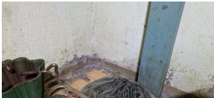
Maling som flasser fra betongvegg under terreng.
