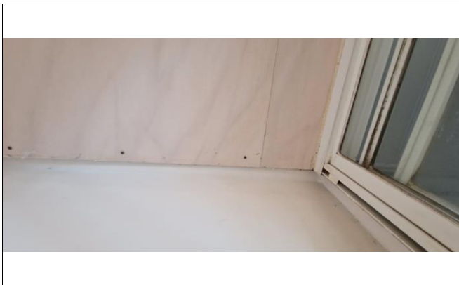
Skruer i nedre kant av våtromsplater inni dusjonen ved badet i 1.etg.
