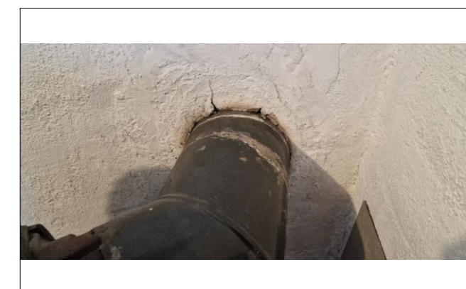
Små riss/sprekker ved inntak av røykløp fra ovn til pipe, sett fra kjeller.
