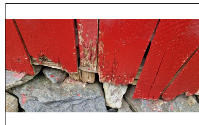
Naust: råte på nedre deler av stående malt kledning.
