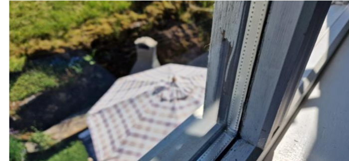
Råte i utvendig trelist til vindu sett fra soverom på loft.
