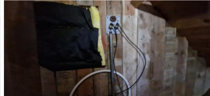
Eldre inntak er frakoblet iht. eier.
