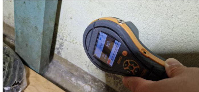
293 av maks 999 ved vegg under terreng.
