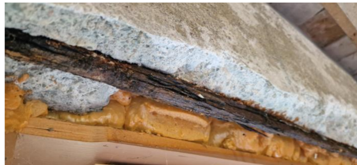
Armeringsjern har rustskader, tiltak bør påregnes.
