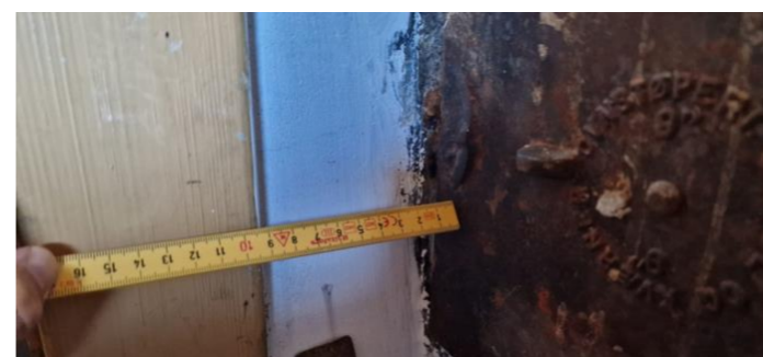
Det er under 30 cm fra sotluke til treverk.
