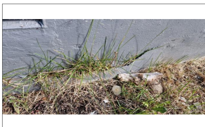
Puss på mur til bolig trenger tiltak.
