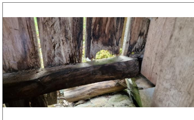
Råte på garasje og kledning.
