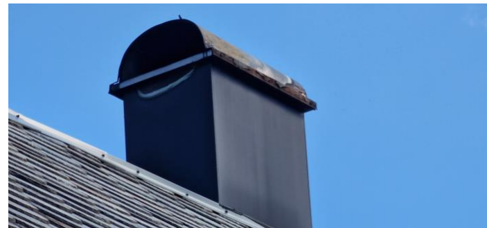
Observert rust og slitasje på heldekkende pipehatt.
