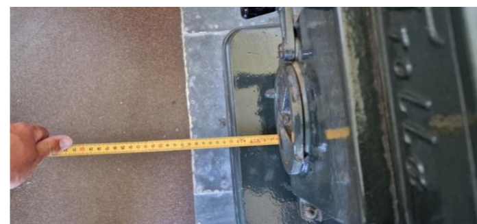
Det er under 30 cm fra ovn til gulv uten ildfast plate.
