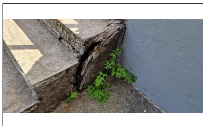
Løs puss/betong ved utvendig trapp.
