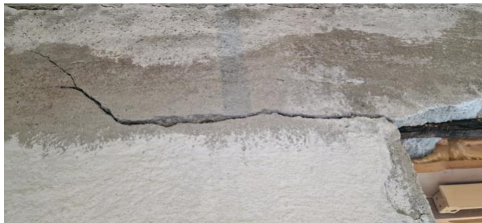
Sprekker over vindu. Vinduet montert og er etablert av eier.
