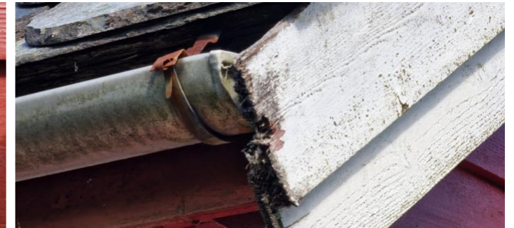
Antatt råtedannelse ved og mulig lekkasje ved endre at takrenne. Påregnet tiltak.
