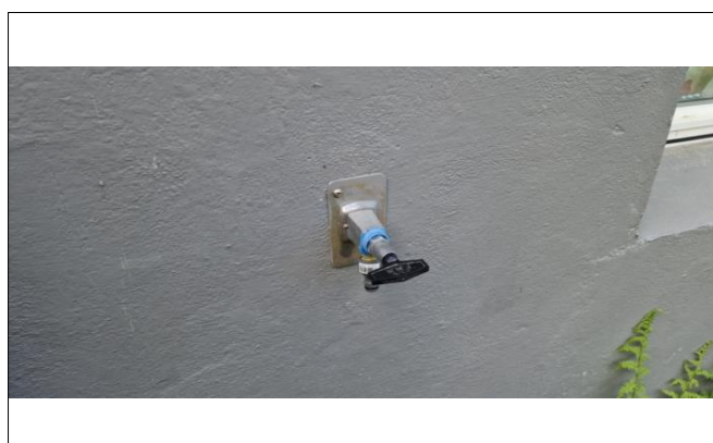
Utkast ved inngangsdør i kjelleren til boligen.
