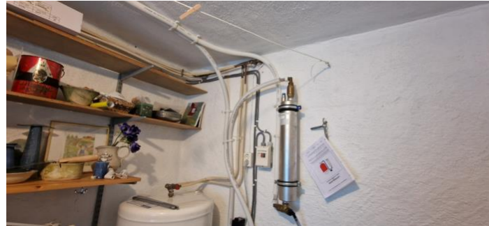
Kobber og rør i rør.
