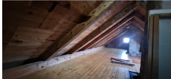
1 stk. PVC vindu på loftet + 1 stk. jern-takvindu. Ellers ikke observert lufting.
