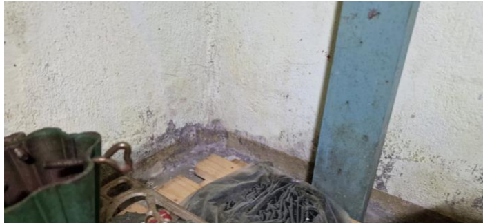
Maling som flasser fra betongvegg under terreng.
