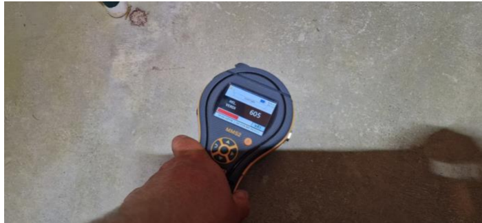
605 av maks 999 ved fuktsøk å gulv i bod. Det kan bemerkes at vi har hatt en lengre tid med tørt og fint vær.
