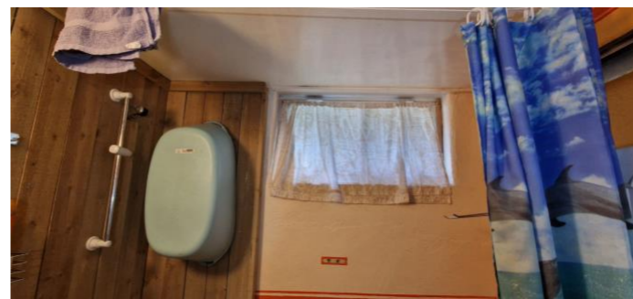
Vindu er plassert i dusjsone. Tilsvarende gjelder trepanel.
