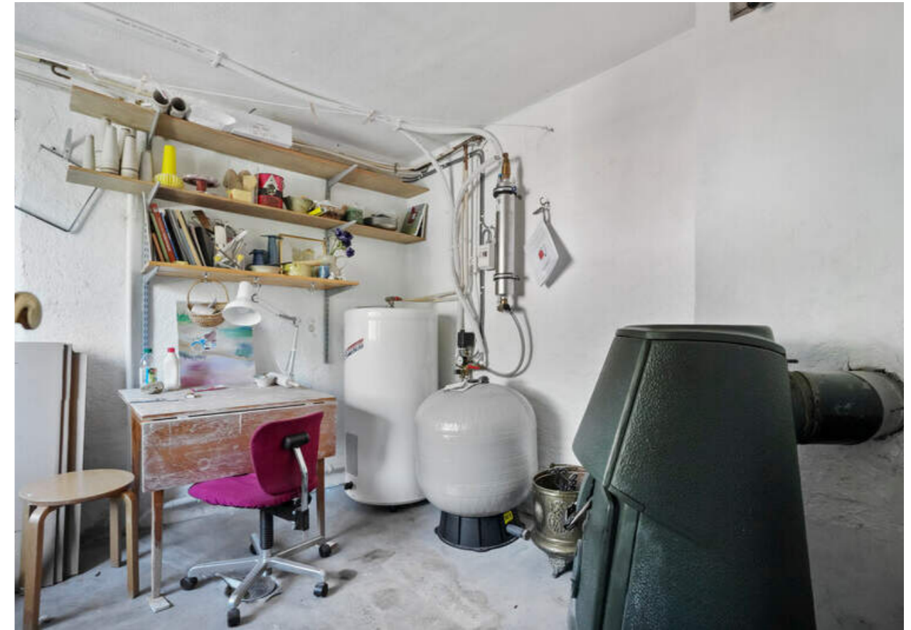
- Bod /teknisk rom med vv- tank og pumpe for vann -
