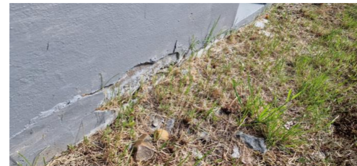
Enkelte områder med murpuss har løsnet utvendig. Samt sprekker. Det må påregnes tiltak.
