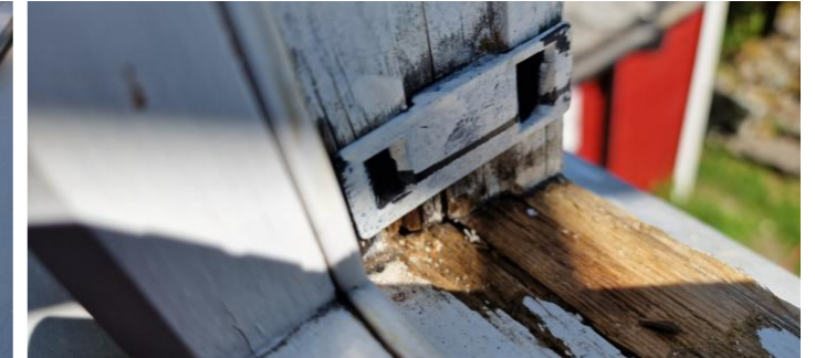
Råte i trekarm til vindu, sett fra soverom på loft.
