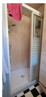
Det er ikke sluk ellers i rommet, og ev. lekkasjevann må over skyvedørs-karmen til dusjkabinettet for å lede til sluk.
