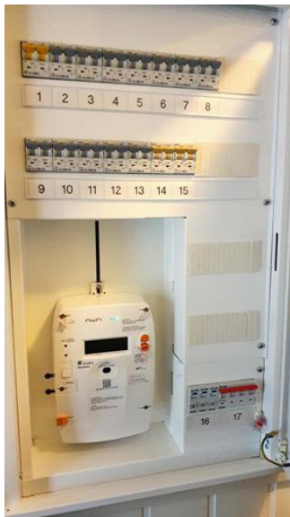
Elektrisk anlegg - [Sikringskap]
