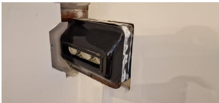
Skrusikringer ved inntaket.
