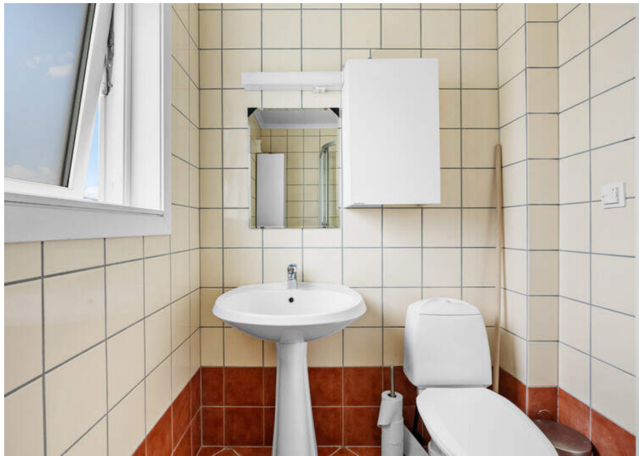
- Praktisk badrom med varme i gulv. Det er mekanisk avtrekk. Dør til badet er fra 2022 -
