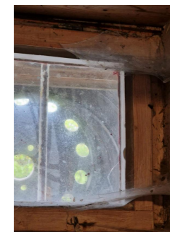
Sprekk i rute på vinduet i kjelleren.
