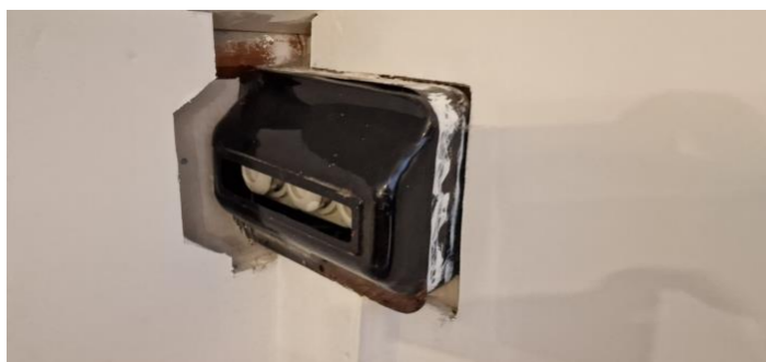
Skrusikringer ved inntaket.
