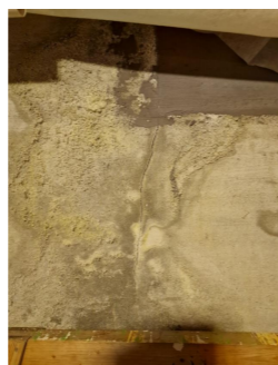
Synlig sprekk i yttervegg av mur/betong finne på fellesarealet.
