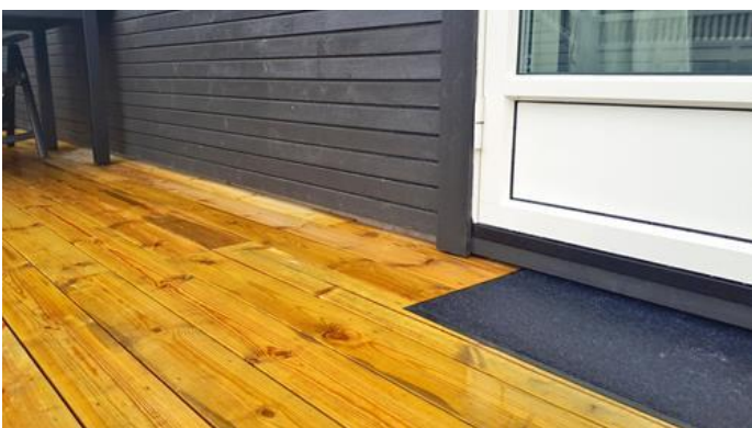
Yttervegger inkl. fasader og konstruksjon - [Liten avstand mellom utvendig kledning og terrasse]
