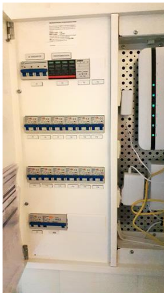
Elektrisk anlegg - [Sikringskap]
