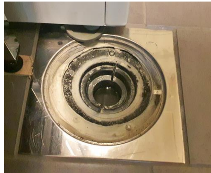
Våtrom - [Sluk, vaskerom]
