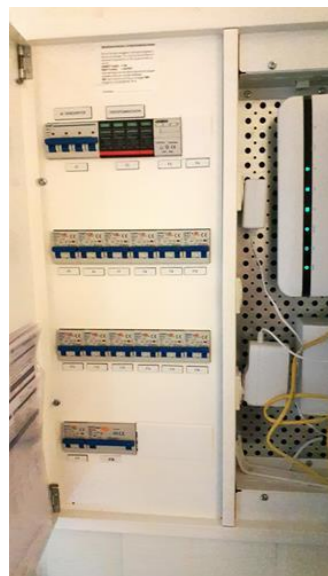
Elektrisk anlegg - [Sikringskap]
