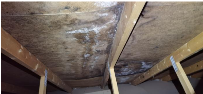
Missfarga undertaksplater med tilvekst av muggsopp
