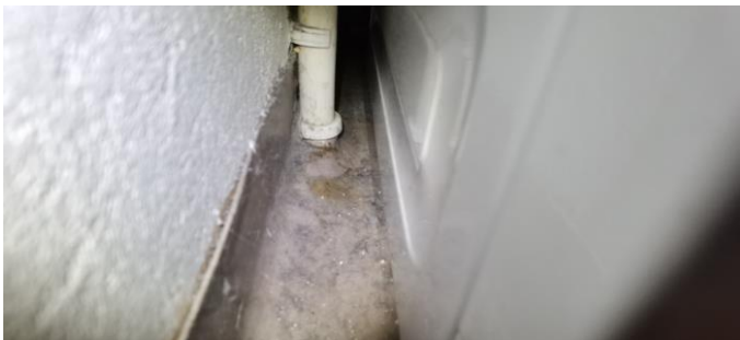
Rørgjennomføring i golv
