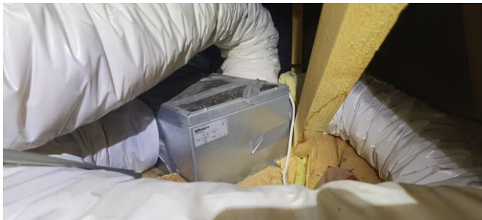
Avtrekkssaggregat på kaldloft
