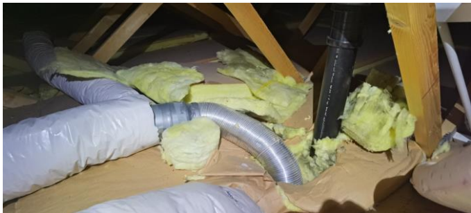
Uisolert del av ventilasjonsrør
