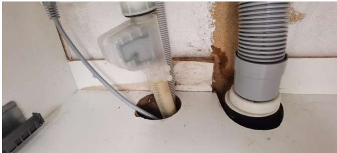
Fuktskada del av benkeskap under vask
