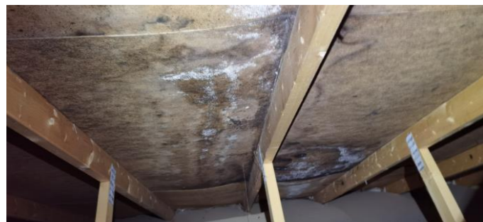
Missfarga undertaksplater med tilvekst av muggsopp
