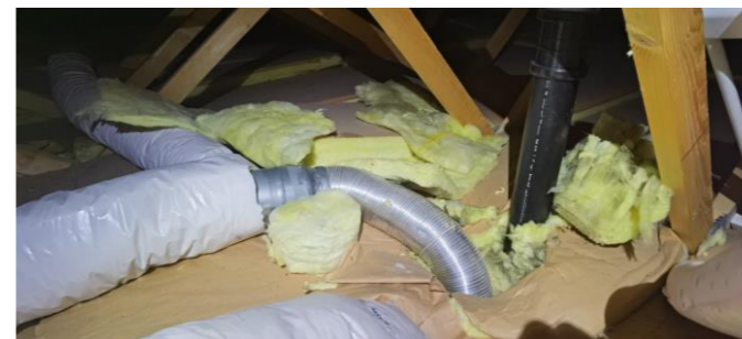
Uisolert del av ventilasjonsrør
