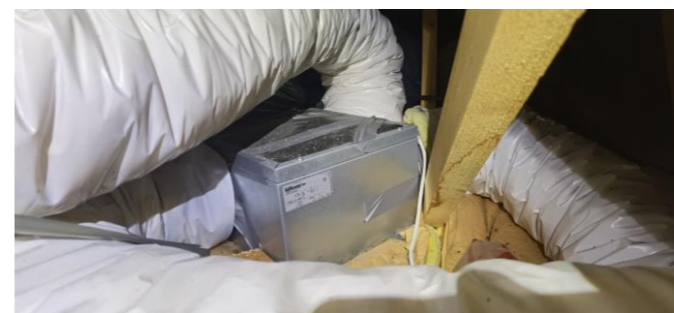
Avtrekkssaggregat på kaldloft
