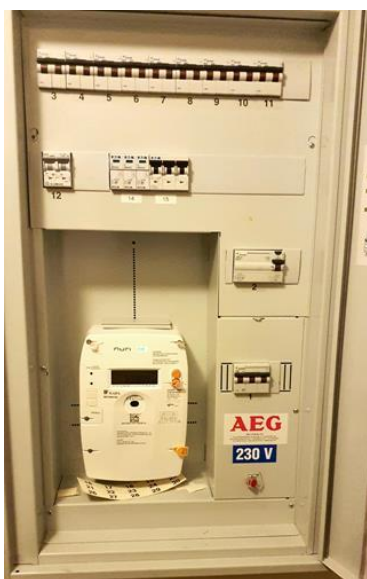
Elektrisk anlegg - [Sikringskap]
