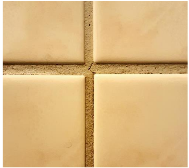
Våtrom - [Riss i fuger på bad ]
