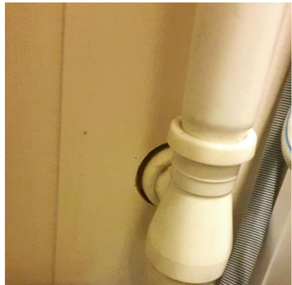
Våtrom - [Rørgjennomføring, vaskerom ]
