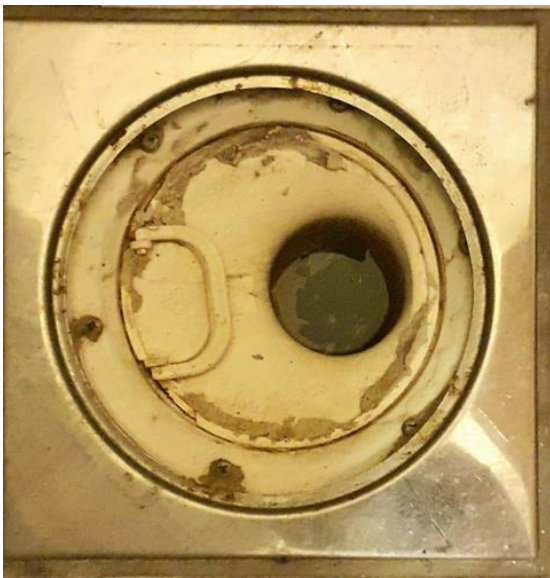
Våtrom - [Sluk, vaskerom]
