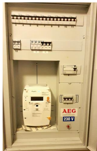
Elektrisk anlegg - [Sikringskap]
