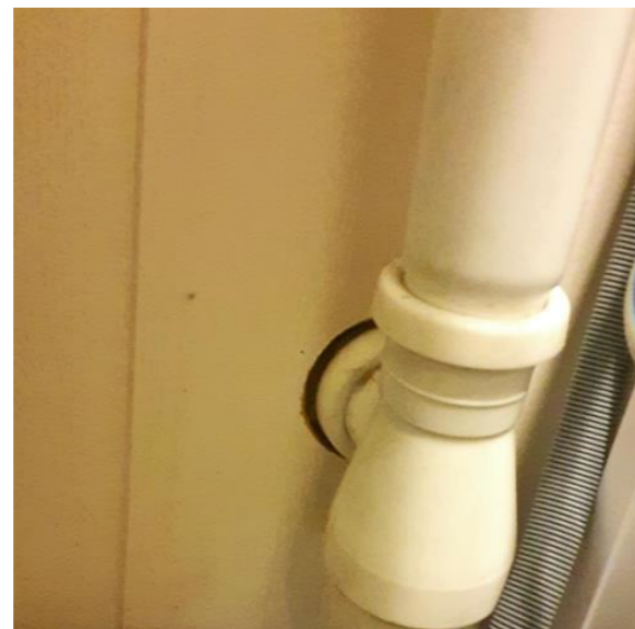
Våtrom - [Rørgjennomføring, vaskerom ]
