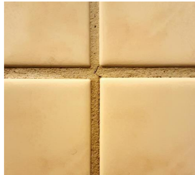
Våtrom - [Riss i fuger på bad ]
