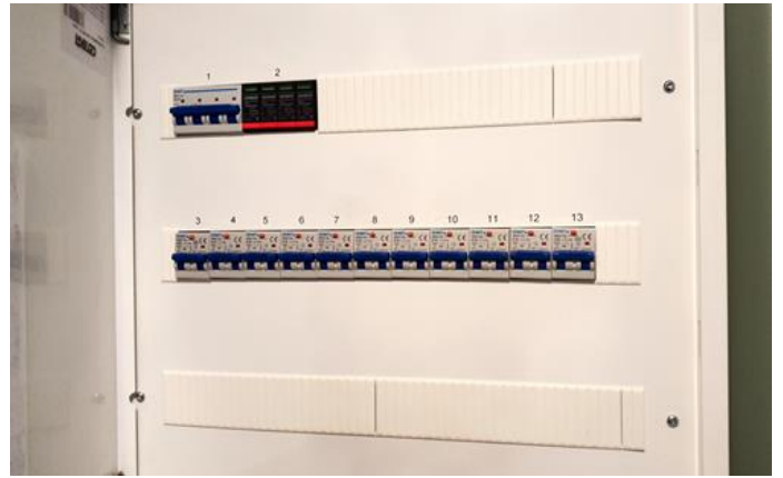
Elektrisk anlegg - [Sikringskap ]
