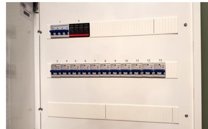
Elektrisk anlegg - [Sikringskap ]
