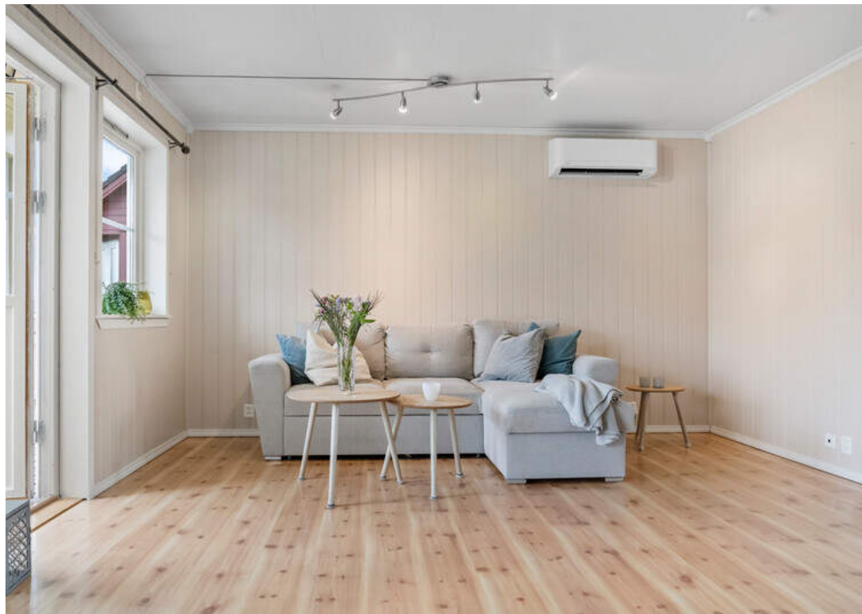
- Varmepumpe er fra 2024. Samt peis i andre del av stuen -
