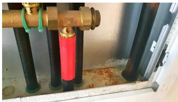
Tekniske anlegg, VVS anlegg (Sjekkpunkter utover det som er inkludert i andre rom) - [Fordelerskap ]
