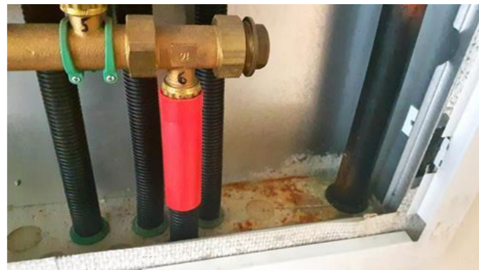
Tekniske anlegg, VVS anlegg (Sjekkpunkter utover det som er inkludert i andre rom) - [Fordelerskap ]
