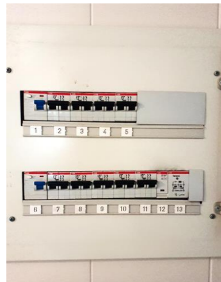
Elektrisk anlegg - [Sikringskap ]
