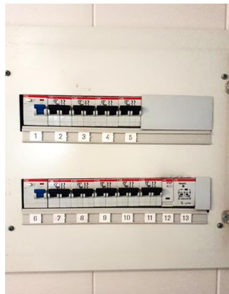
Elektrisk anlegg - [Sikringskap ]
