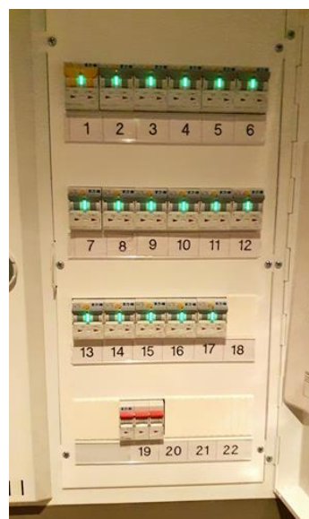
Elektrisk anlegg - [Sikringskap]
