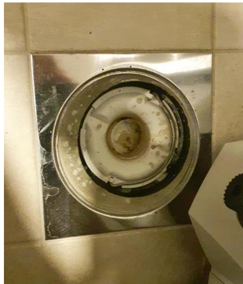
Våtrom - [Vaskerom underetasje, sluk]
