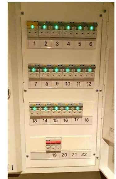
Elektrisk anlegg - [Sikringskap]
