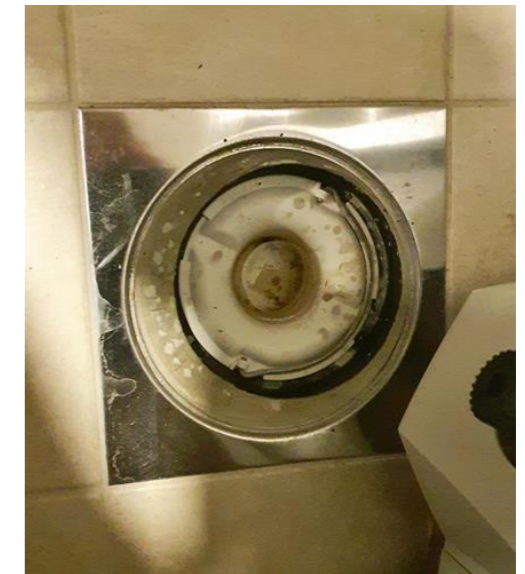
Våtrom - [Vaskerom underetasje, sluk]
