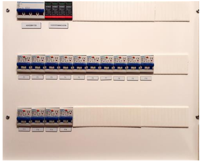
Elektrisk anlegg - [Sikringskap ]
