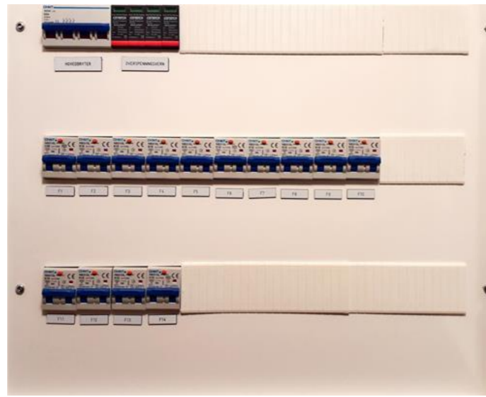
Elektrisk anlegg - [Sikringskap ]
