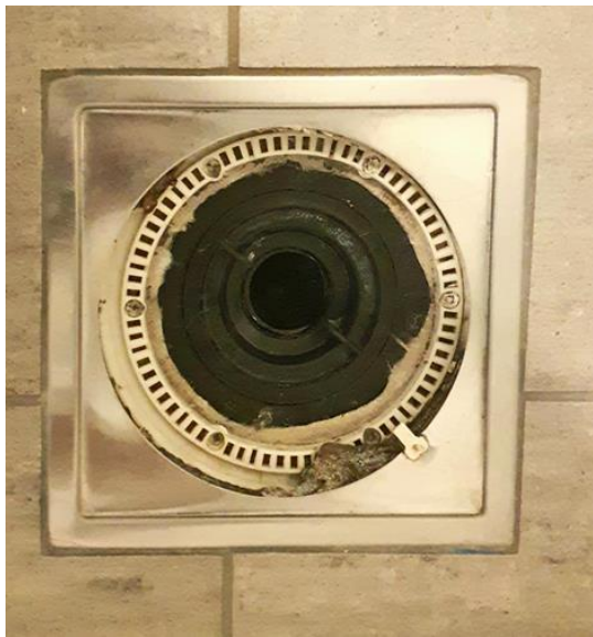
Våtrom - [Sluk, bad ]
