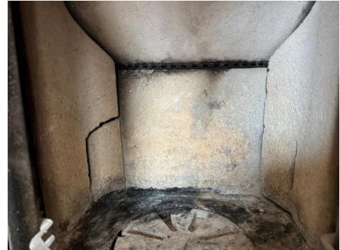
Sprekk i ildfast stein inni peisovnen.
