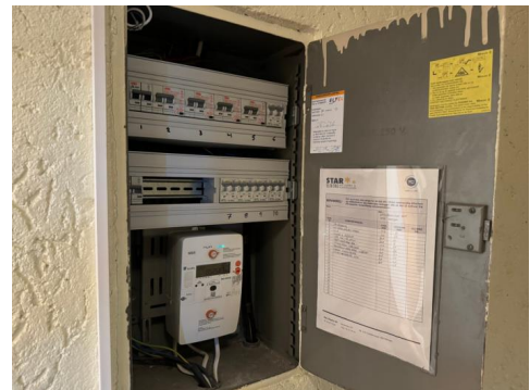
Sikringsskap i fellesarealer.
