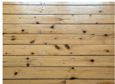
Sitasje/striper i gulv på kjøkken.
