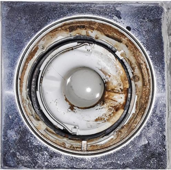
Våtrom - [Sluk bad underetasje]
