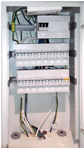
Elektrisk anlegg - [Sikringskap 1. etasje]
