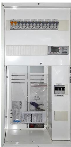
Elektrisk anlegg - [Sikringskap underetasje]
