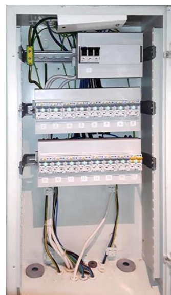
Elektrisk anlegg - [Sikringskap 1. etasje]
