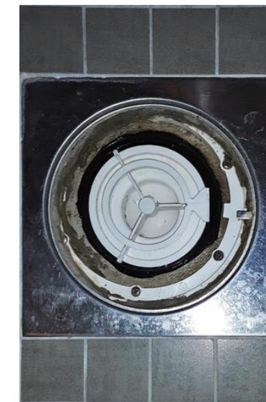
Våtrom - [Sluk bad 1. etasje]
