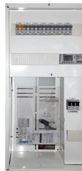
Elektrisk anlegg - [Sikringskap underetasje]
