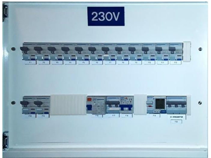
Elektrisk anlegg - [Sikkeringskap]
