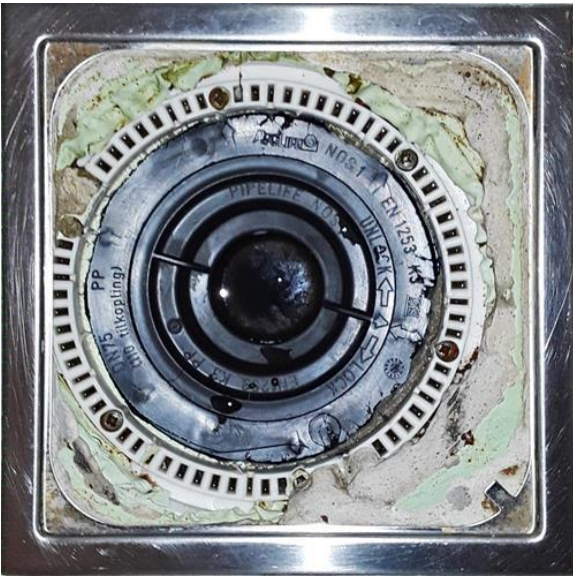
Våtrom - [Sluk bad leilighet i underetasje]
