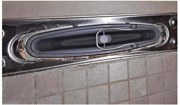
Våtrom - [Sluk bad 1. etasje]
