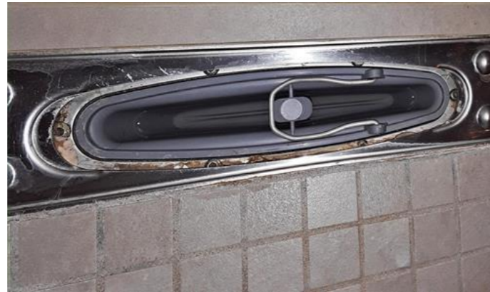
Våtrom - [Sluk bad 1. etasje]
