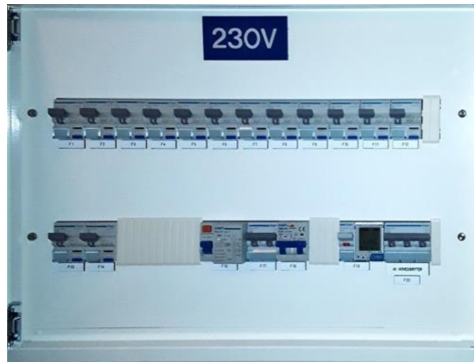
Elektrisk anlegg - [Sikringskap]
