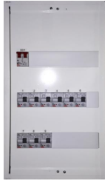
Elektrisk anlegg - [Sikkeringskap]
