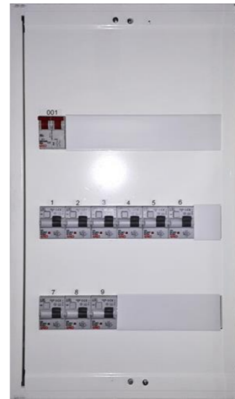
Elektrisk anlegg - [Sikringskap]
