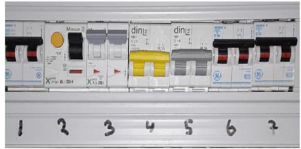
Elektrisk anlegg - [Sikringskap]
