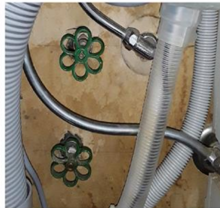
Tekniske anlegg, VVS anlegg (Sjekkpunkter utover det som er inkludert i andre rom) - [Stoppekranter - Kjøkken]
