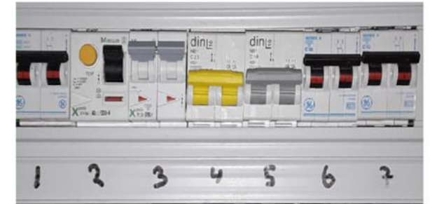
Elektrisk anlegg - [Sikringskap]
