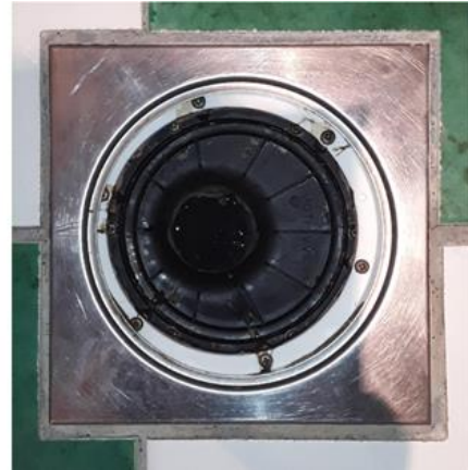
Våtrom - [Sluk - Bad loftsetasje]
