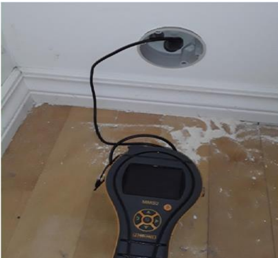
Våtrom - [Hulltaking og fuktmåling fra tilstøtende rom til bad i loftsetasje - Soverom]
