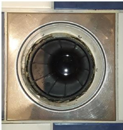
Våtrom - [Sluk - Bad underetasje]
