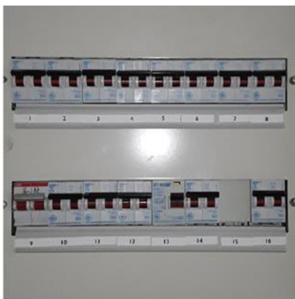
Elektrisk anlegg - [Sikringskap]
