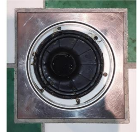
Våtrom - [Sluk - Bad loftsetasje]
