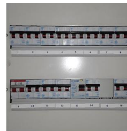
Elektrisk anlegg - [Sikringskap]
