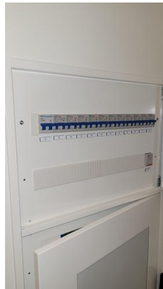
Elektrisk anlegg - [Sikringskap]
